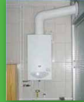
Conducto de evacuación ascendente en todo su recorrido
