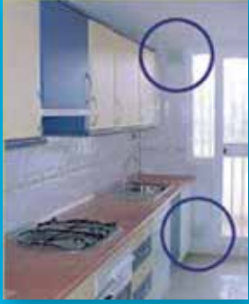
Cocina con ventilaciones correctas
