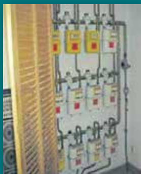
Instalación centralizada de contadores
